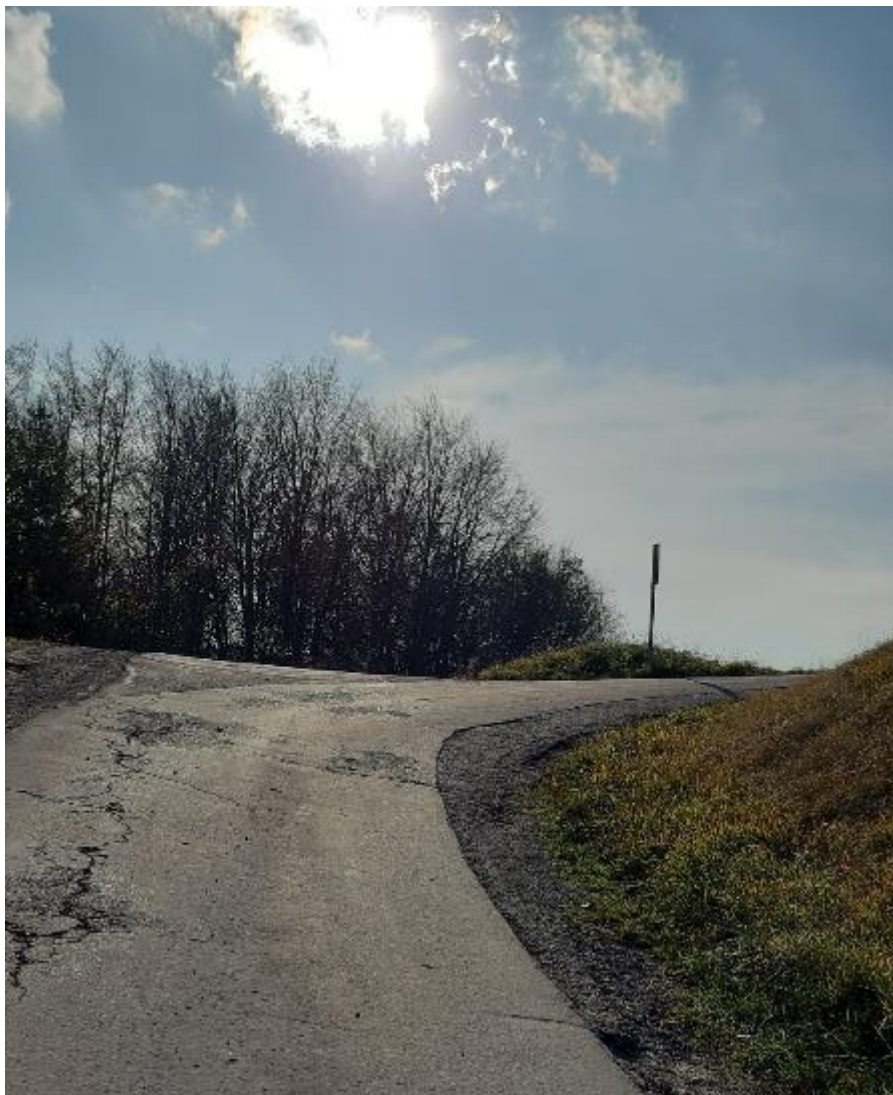
Slika 37: Nevaren odsek št. 12
